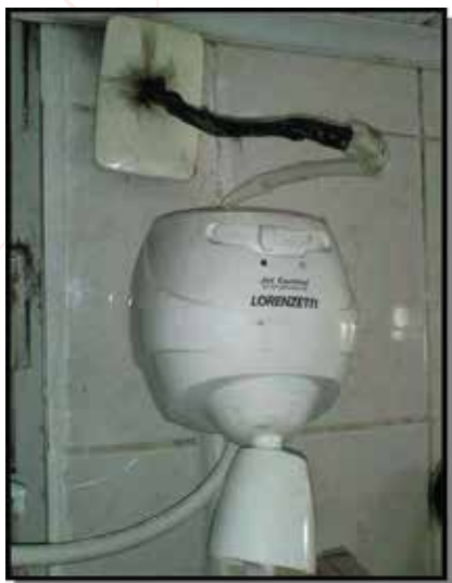
Se evidencia que el producto fue mal instalado
